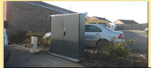
Première armoire installée dans la rue Henri Barbusse.
