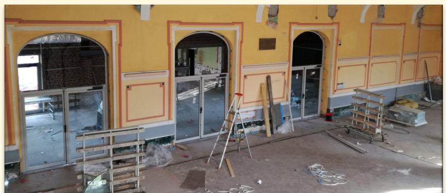
De nouvelles menuiseries ont été posées au niveau des arcades de la salle principale et de la véranda.
